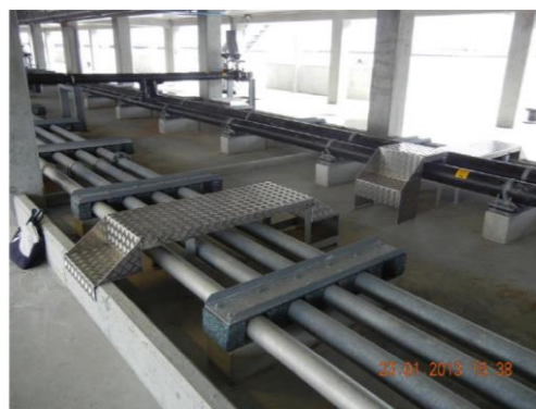
Figure 52 : Positionnement des réseaux dans la galerie centrale bordée de murets de rétention
